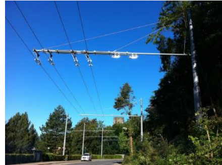
Fahrleitung Büttenen, Luzern
