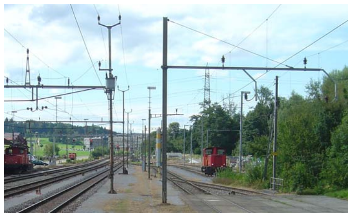
Abbildung 12: Anschluss- und Abstellgleise mit separater Stromleitungsaufhängung
